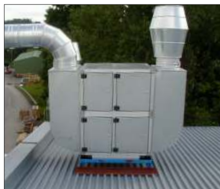
• Chemický filtr instalovaný ve firm ELK (Planá nad Lužnicí, R).
