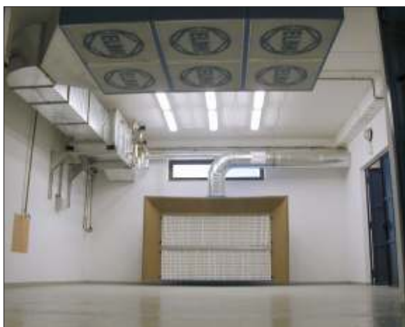
• Kompletní vybavení lakovny - firma ELK (Planá nad Lužnicí, R)
