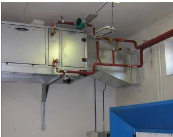
• Teplovzdušná jednotka ZLG instalovaná ve firmě ELK (Planá nad Lužnicí, ČR).
